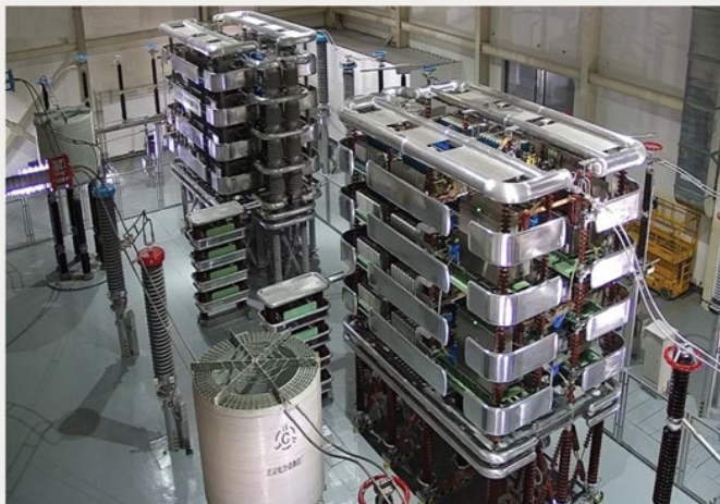
Гибридный высоковольтный выключатель постоянного тока \pm 200 кВ
